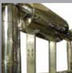
Isolation thermique Manifold
