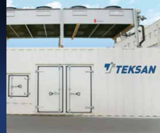
1 x 1240 kVA Doğalgaz Jeneratör Seti
