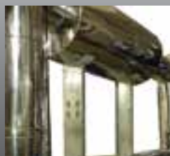
Тепловая изоляция воздушного коллектора
